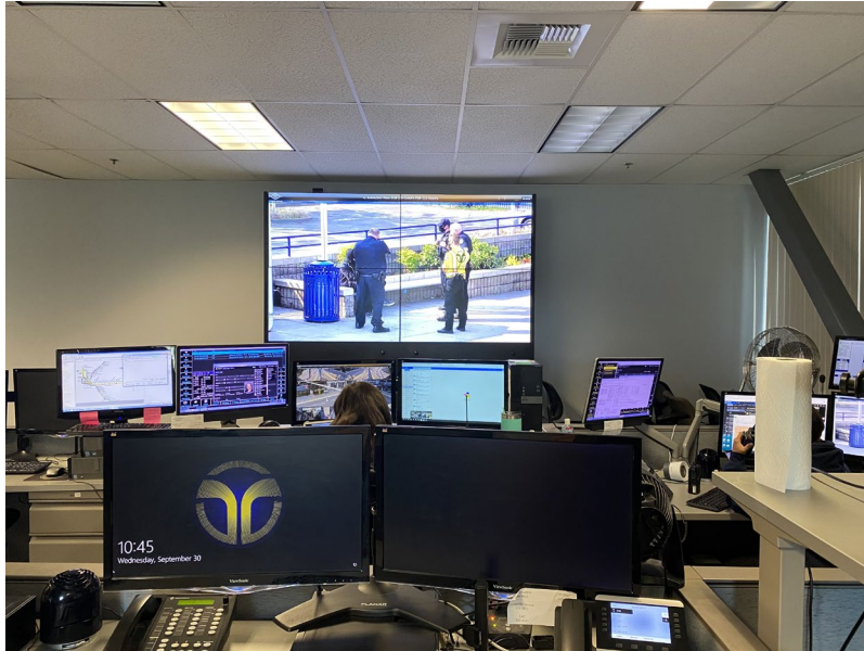
SOC Video Wall (Before)
